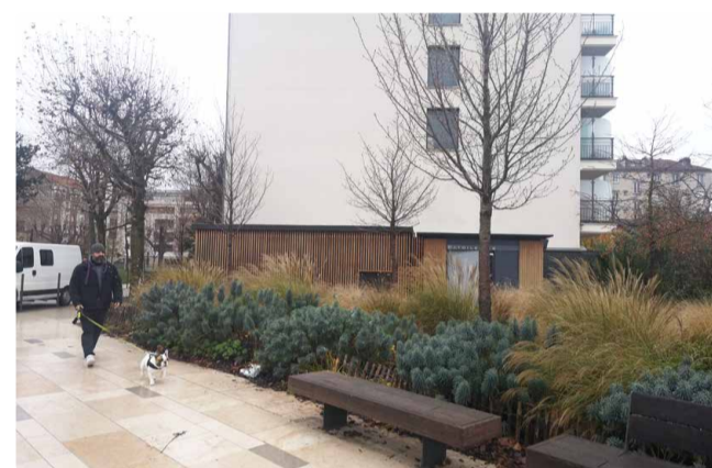
Intégration d'un poste de transformation en coeur urbain, adossé à un pignon d'immeuble. Habillage en lattes de bois verticales, ouvertures, couverture en bas acier sombre. Toilettes publiques attenantes du même habillage. Montrouge (92).
